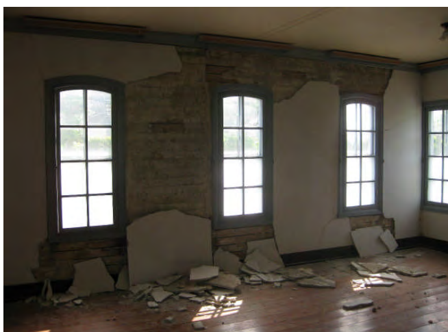
内壁の剥落（旧水海道小学校本館）
